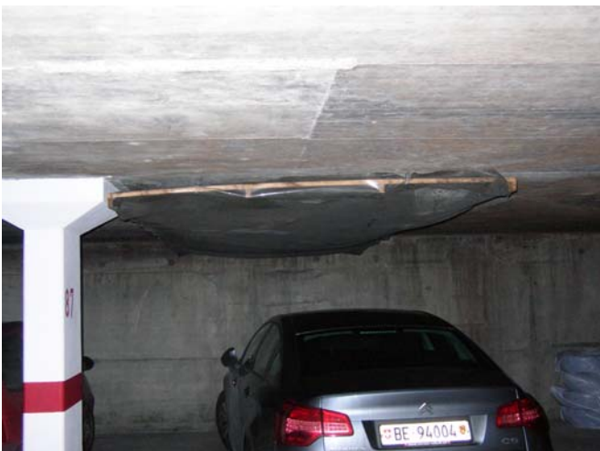
Im Bereich Autoabstellplätze Halle 18/22, speziell Parkplätze 87 - 90, bildet sich Kondensat an Decke (gute Querlüftung fehlt). Angebrachte Schutzdächer in Plastik entsprechen nicht der GVB-Vorschrift.
