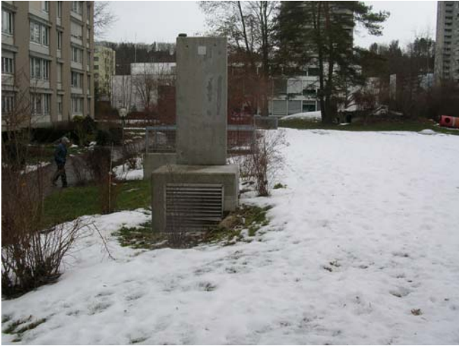
Aussenzuluft in Halle 24.
