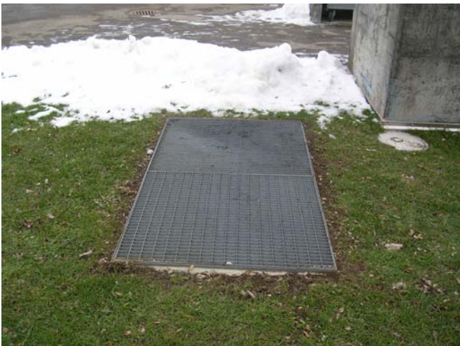
Austritt Lüftung in Rasenfläche.
