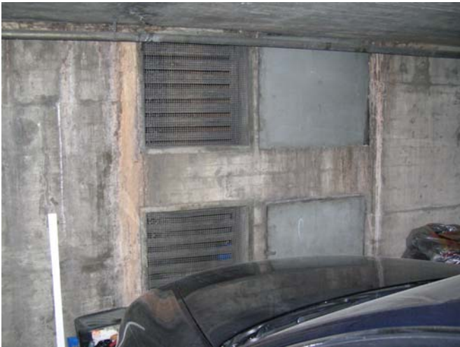
Nur ein Abluftventilator für die ganze Halle 18/22 und 24. Da die gesamte Fläche, ca. 130 Autoabstellplätze, mit einem Gerät ausgerüstet ist, kann nicht von einer optimalen Entlüftung gesprochen werden.
